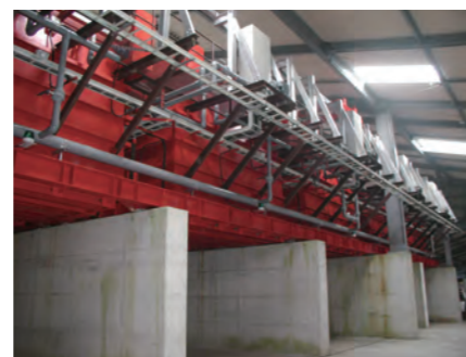
コンポスト化プラント設備
