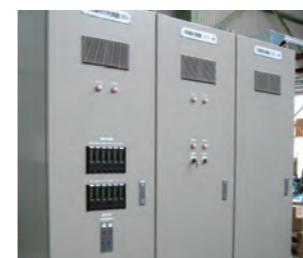
制御盤の設計・製作
