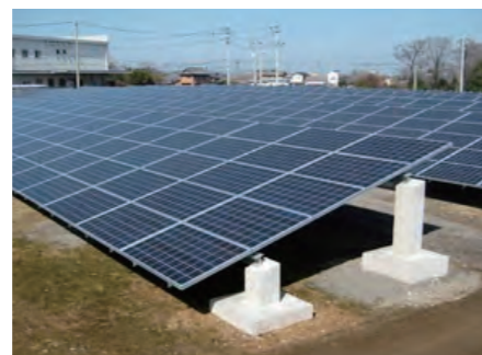
太陽光発電設備
